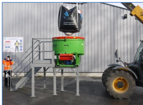
MINI-CENTRALE À BÉTON
